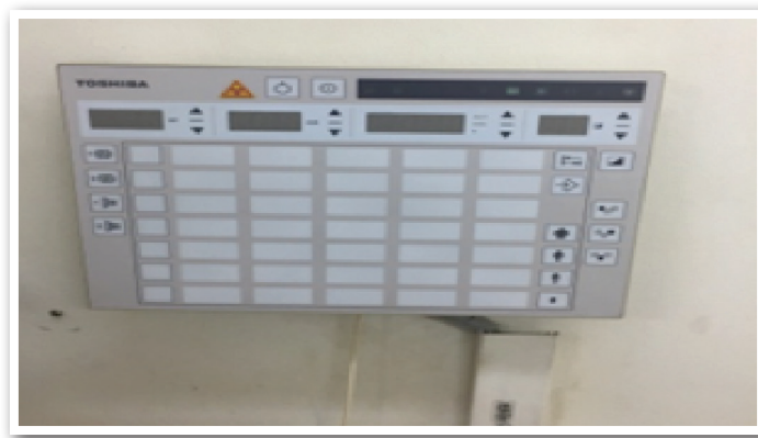
ชุดควบคุม (X-ray Control Unit)
